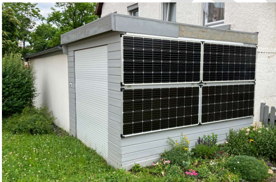
Abbildung 31: Beispiel für Kleinanlagen an Fassaden (Foto swt)
